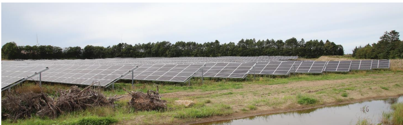
Figur 1: Solceller monteret på faste stativer
