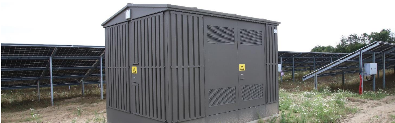
Figur 2: I dette layout sidder invertere som en hvid kasse under solpanelerne og fordelingstransformer ses i forgrunden.
