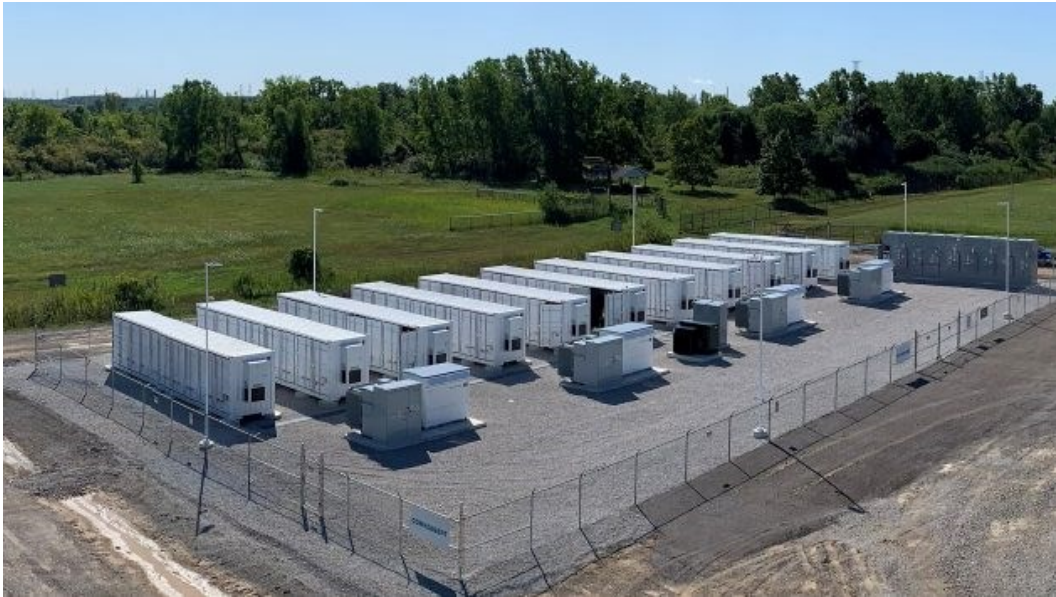
Figur 7 viser et eksempel på et storskala batterisystem
