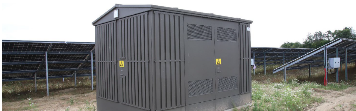
Figur 2.2: De hvide kasser under solcellerne er invertere, som omdanner jævnstrømmen til vekselstrøm og eksempel på teknikbygning, her en typisk fordelingstransformer.
