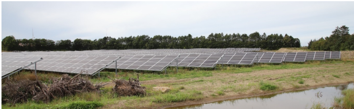
Figur 3.1: Solceller monteret på faste stativer
