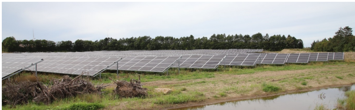
Figur 2.1: Solceller monteret på faste stativer
