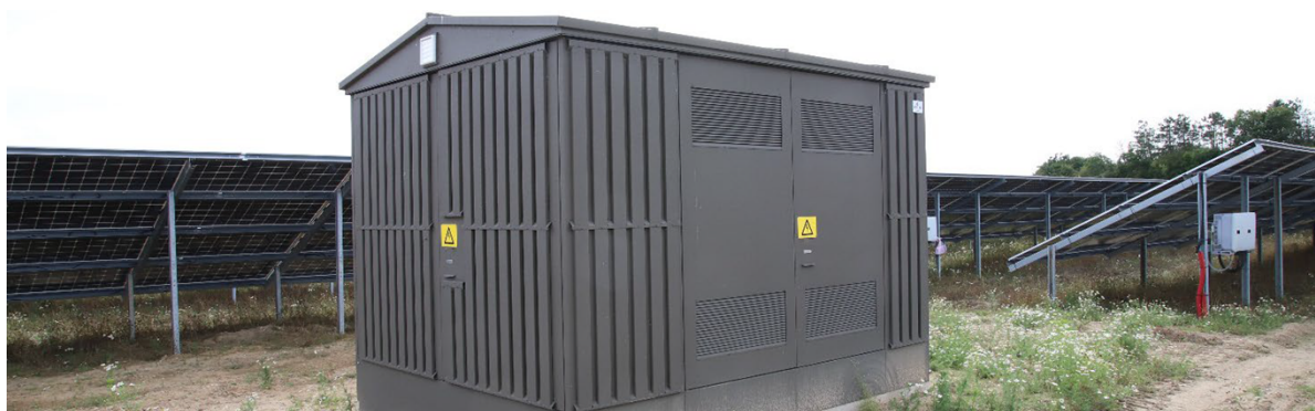
Figur 3.3: De hvide kasser under solcellerne er invertere, som omdanner jævnstrømmen til vekselstrøm og eksempel på teknikbygning, her en typisk fordelingstransformer.
